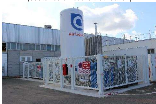
Nouvelle plateforme gaz à l'entrée du site (bouteilles en cours d'utilisation)
